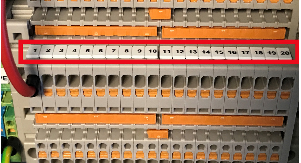
Nummerierung der Klemmen auf der Oberseite der Verteilerleiste
